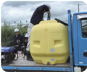
攪拌機で重曹を水に溶かす
